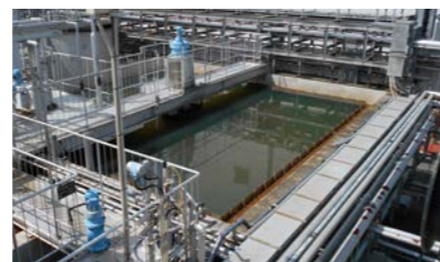
事業場内に設置された排水処理設備
