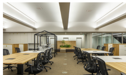
天井そのものを温めたり冷やしたりする、ふく射空調システムを導入
