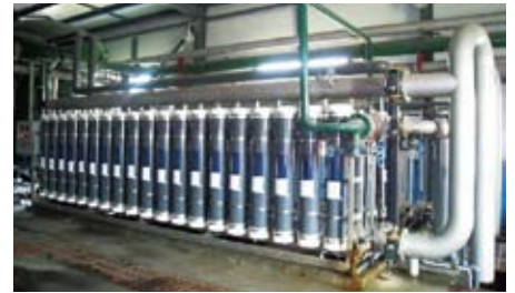
大型水処理装置
