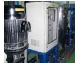
流量調整が可能な水供給ポンプ
