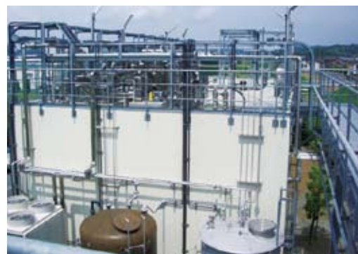
排水処理施設（東海事業場）
