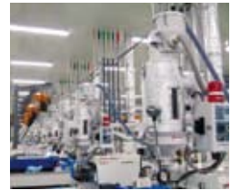
断熱材を巻いた加熱装置
